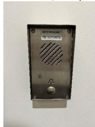
Interphone PC Sécurité (dans le palier du R+2)
